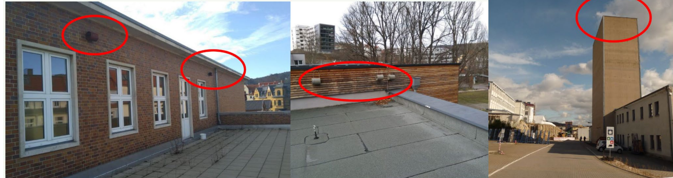
Ersatzkästen an Gebäude Otto-Schott-Straße und Gesamtschule (Foto: Nickel, Gutachter Schulz UmweltPlanung)
